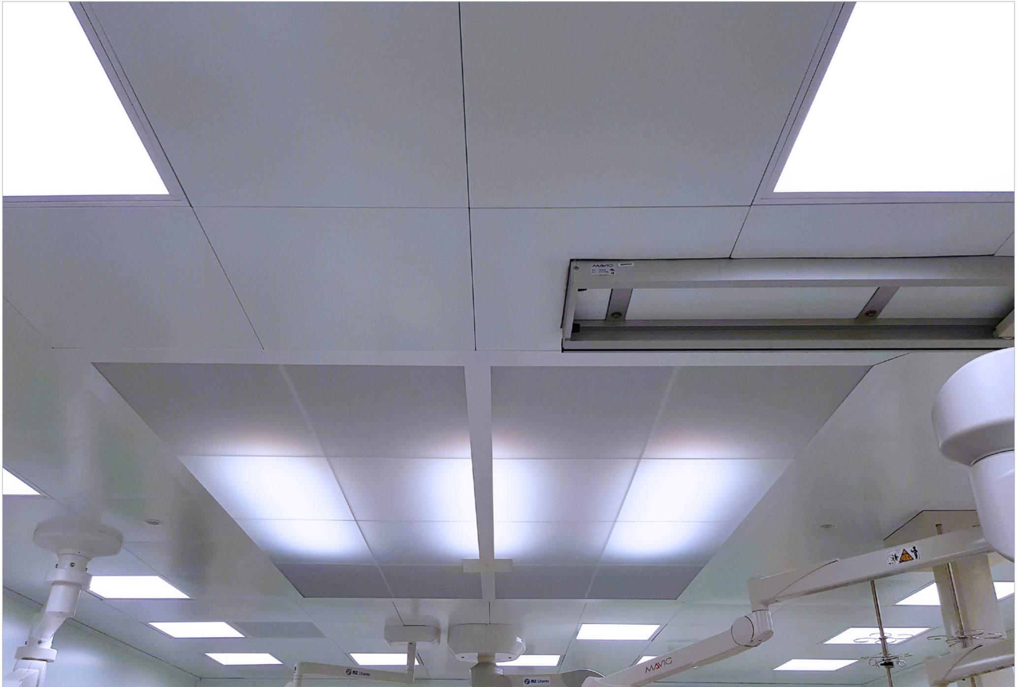
Hybrid operating theatres, Hospital Košice | Východoslovenský ústav srdcových a cievnych chorôb, a.s. | Slovakia | 2019
